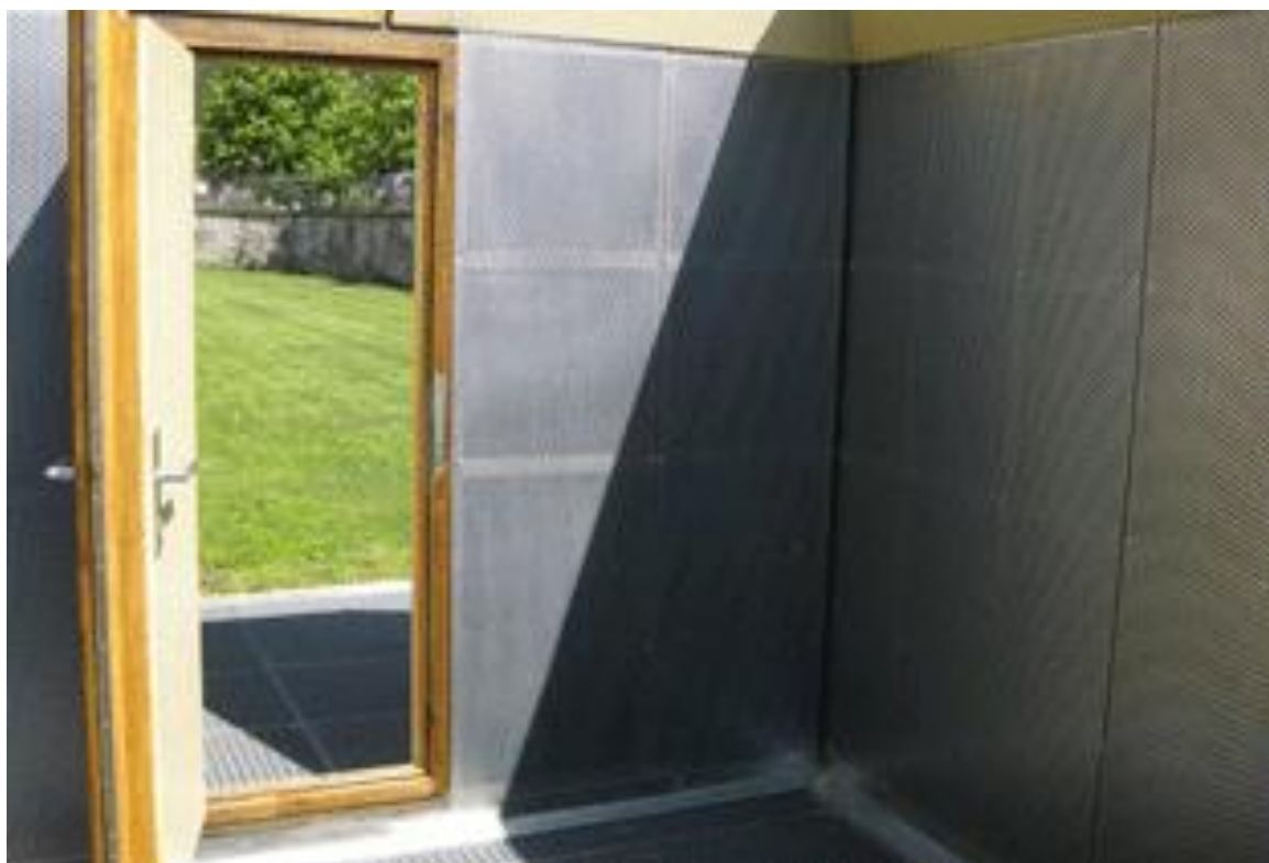
Bild oben: Einhausung eines großen unterirdischen Klimaaggregates - oben offen zur Wärmeableitung
